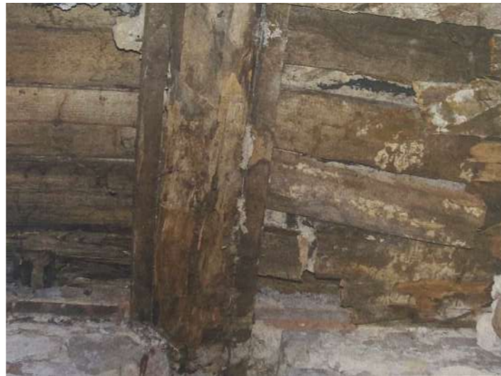
Руйнування перекриття в приміщенні добудови
