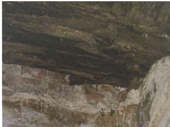
Руйнування перекриття в приміщенні добудови
