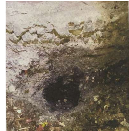
Бетонний фундамент під несучу стіну по осі А. Зволоження ґрунту. Відсутність горизонтальної гідроізоляції
