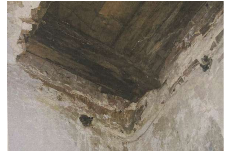
Руйнування перекриття в приміщенні добудови
