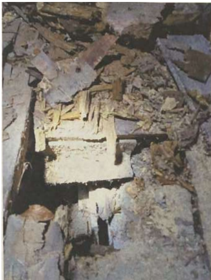
Руйнування верхнього дерев'яного настилу перекриття над залом будинку культури
